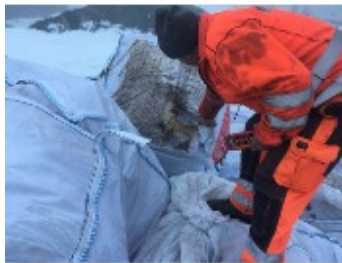
Interdit contact direct avec des déchets d'amiante
