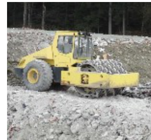
Interdit Compactage de déchets d'amiante-ciment sans couverture suffisante
