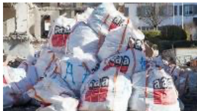
Livraison incorrecte de déchets d'amiante avec un potentiel d'émission élevé ; ceux-ci devraient être doublement emballés.
