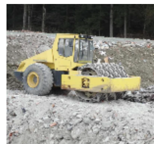
Verboten: Verdichten von Asbestzementabfällen ohne ausreichende Überdeckung
