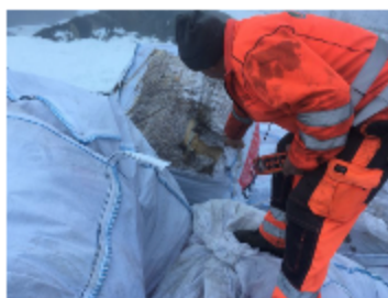
Verboten: direkter Kontakt mit Asbestabfällen
