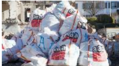
Unsachgemässe Lieferung von Asbestabfällen mit erhöhtem Emissionspotential; diese müssten doppelt verpackt sein.
