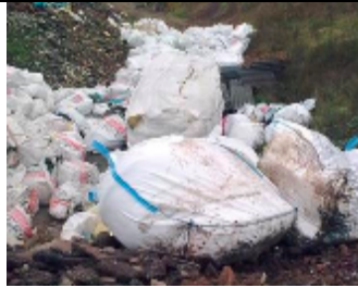
Einbau von Asbestabfällen ohne sofortige Überdeckung ist verboten
