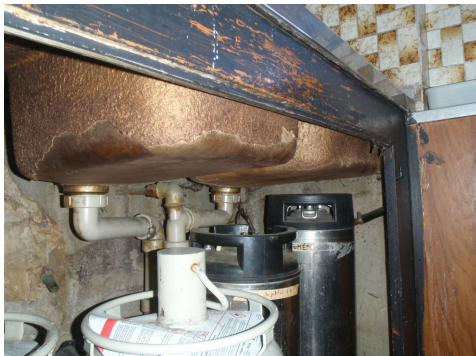
Intonaco/protezione antirombo contenente amianto sotto il lavello.
