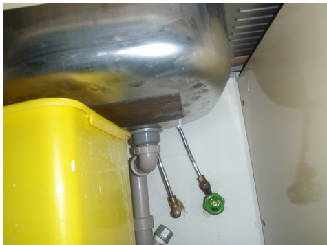
Pannello bituminoso antirombo sotto i lavandini (qui senza amianto).
