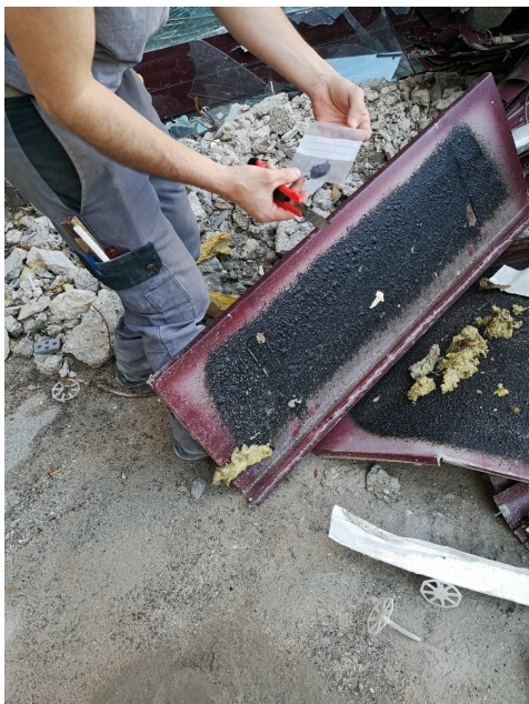
Pannelli di rivestimento di facciate muniti di rivestimento bituminoso contenente amianto. (Foto: C. Campoarmor, Arcadis Svizzera AG)
