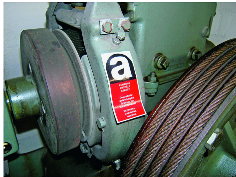
Guarnizioni delle frizioni contenenti amianto
