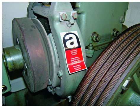
Guarnizioni delle frizioni contenenti amianto
