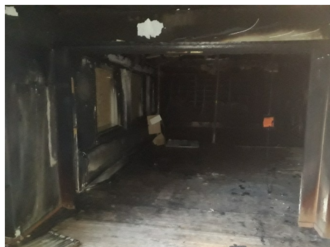
Incendio in un soggiorno di un edificio
