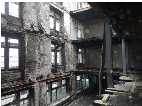
Incendio di vaste proporzioni in un
