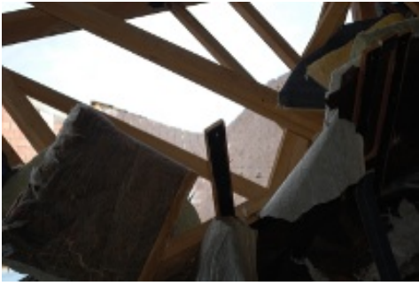
Tetto di fibrocemento di una piscina coperta crollato a causa del peso della neve, Markus Durrer, IBH Expertenstelle Chur
