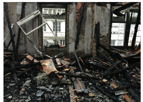
Macerie generate da un incendio:
