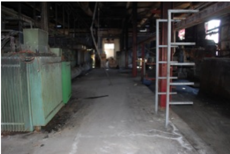
Incendio in un'officina galvanica, acqua di spegnimento contaminata da olio al piano interrato, Markus Durrer, IBH Expertenstelle Chur
