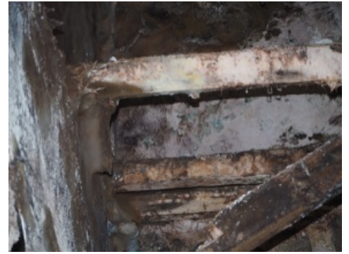
Solaio di un hotel crollato a causa di marcescenza e di attacco da funghi, Markus Durrer, IBH Expertenstelle Chur
