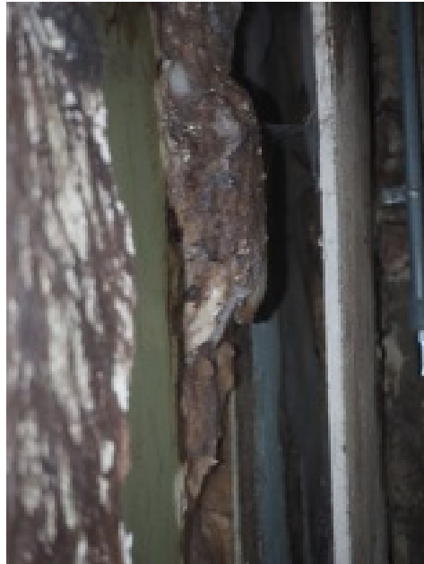
Solaio di un hotel crollato a causa di marcescenza e di attacco da funghi, Markus Durrer, IBH Expertenstelle Chur
