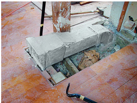
Canale di ventilazione in cemento amianto
