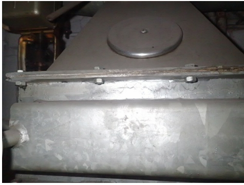
Guarnizione contenente amianto nell'impianto di aerazione. (Foto: C. Campoarmor, Arcadis Schweiz AG)
