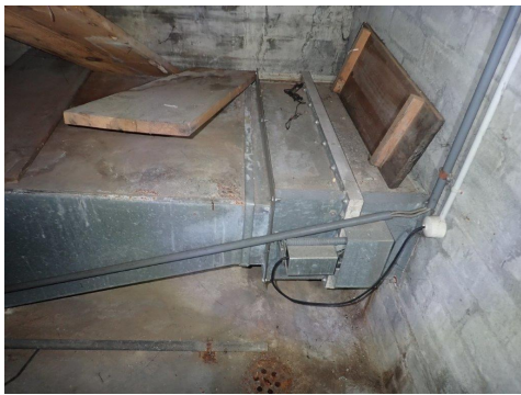
Pannello leggero tra i canali di ventilazione, senza fonte
