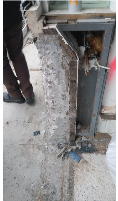
Sughero catramato in una facciata, SCS
