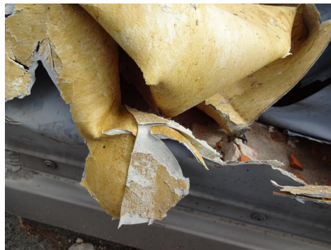
Dettaglio del rivestimento del camino con un manto impermeabile sintetico danneggiato (tipo Hypalon). (Foto: J. Meyer, Solgeo AG)
