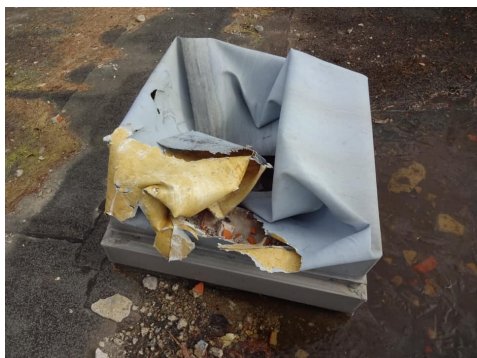
Copertura del camino con un manto impermeabile sintetico danneggiato (tipo Hypalon). Anche il tetto era ricoperto con lo stesso materiale (sotto il manto bituminoso, che è più recente). (Foto: J. Meyer, Solgeo AG)
