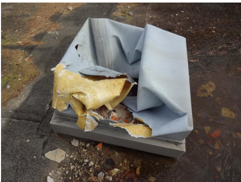
Copertura del camino con un manto impermeabile sintetico danneggiato (tipo Hypalon). Anche il tetto era ricoperto con lo stesso materiale (sotto il manto bituminoso, che è più recente). (Foto: J. Meyer, Solgeo AG)
