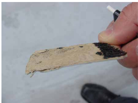
Foto che mostra lo strato contenente amianto (simile al cushion-vinyl). (Foto Carbotech)
