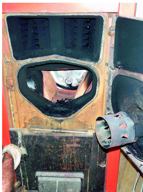
Corde di amianto in una stufa
