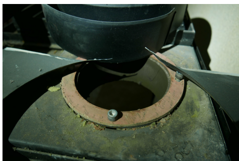
Stufa con guarnizione contenente amianto
