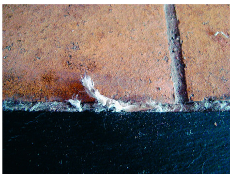
Corda di amianto in un caminetto
