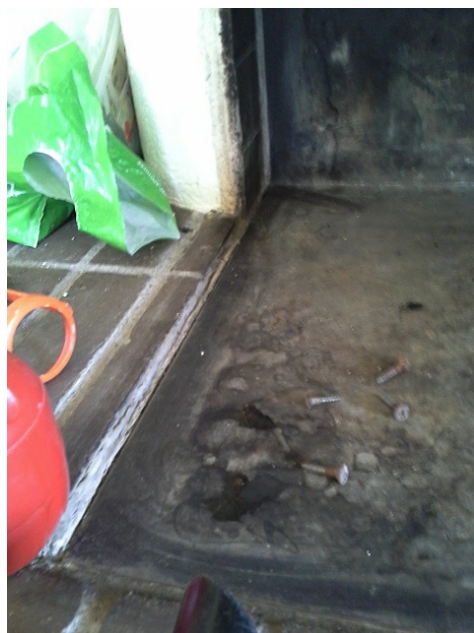
Giunti di dilatazione contenenti amianto
