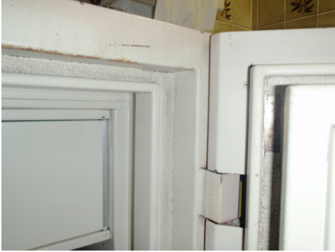
Cassaforte con sportello munito di guarnizione contenente amianto.
