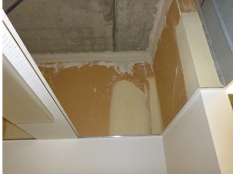
2. Stuccature delle giunzioni tra elementi in cartongesso contenenti amianto. Impiego negli anni '70. (Foto Carbotech AG)
