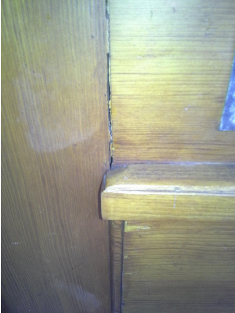
1. Stucco di riempimento contenente amianto su legno. (Foto: Bafob GmbH)
