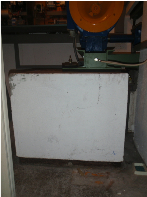
Isolamento in sughero bitumato suscettibile di contenere amianto sotto la base del motore del lift.
