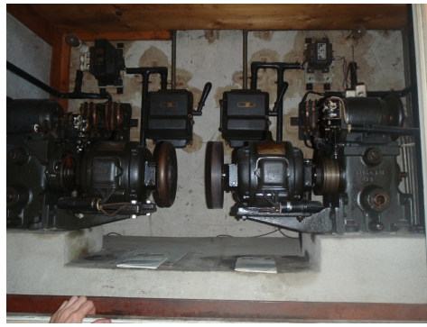
Motore di un montavivande in un ristorante. Le guarnizioni per freni potrebbero contenere amianto.
