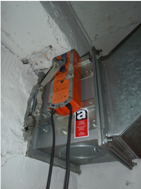
Serranda tagliafuoco. La pala della serranda si trova all'interno dell'apparecchio. (Foto: S. Schneebeli)
