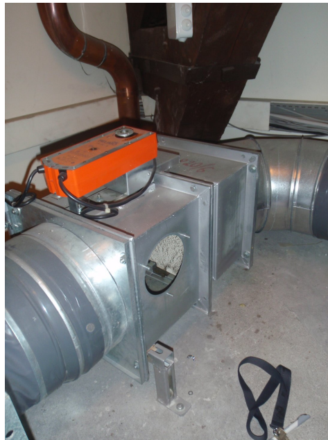
Serranda tagliafuoco in un impianto di aerazione più recente (senza amianto).
