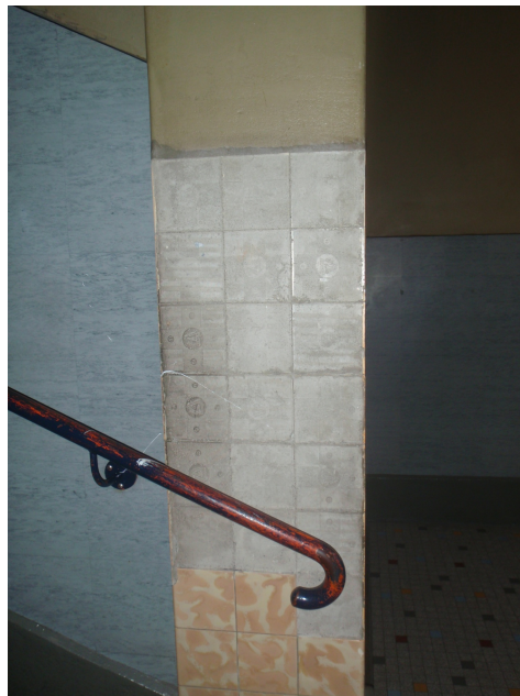
Nel caso in cui le piastrelle posate "a letto pieno" si siano staccate dal supporto, l'adesivo, se in cattive condizioni, può rappresentare un certo rischio durante il normale utilizzo.
