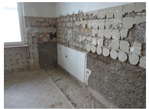
Secondo lo stato attuale delle conoscenze, la malta utilizzata per l'incollaggio puntuale delle piastrelle con la tecnica di posa "dot and dab tiling" non è suscettibile di contenere amianto e quindi il suo campionamento non è necessario. (Foto: Carbotech AG).
