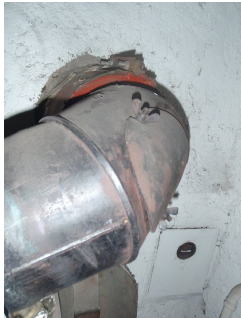
Anche i condotti dei fumi possono essere muniti di guarnizioni in tessuto di amianto.
