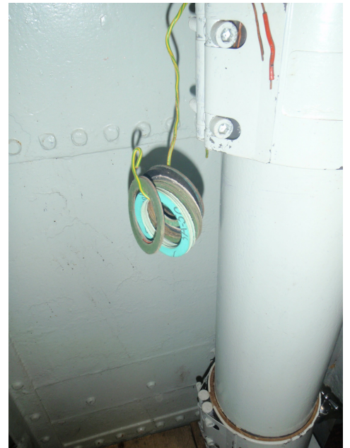
Riserve di guarnizioni che possono contenere amianto.
