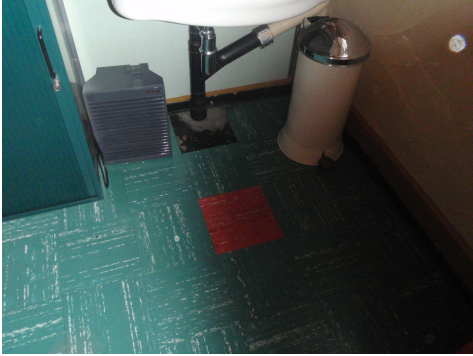
Rivestimenti per pavimenti in piastrelle viniliche contenenti amianto.
