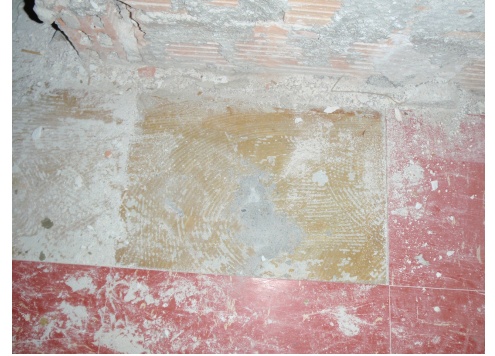
Adesivo non bituminoso del rivestimento: vinilico questo materiale è suscettibile di contenere amianto.
