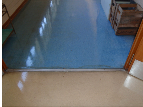
Rivestimento per pavimenti tipo Linoleum: questo tipo di rivestimento è suscettibile di contenere amianto.
