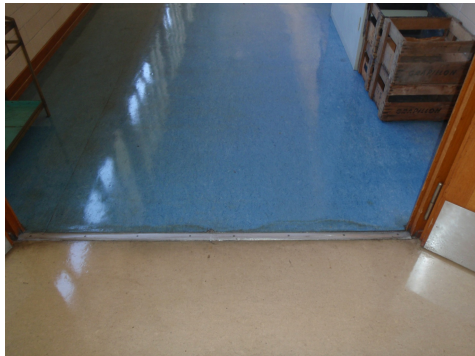
Rivestimento per pavimenti tipo Linoleum: questo tipo di rivestimento è suscettibile di contenere amianto.
