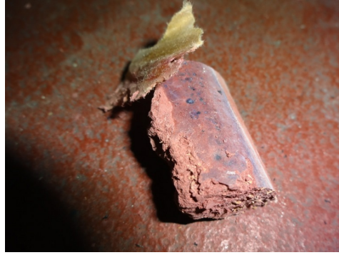
Pavimento in legno-cemento contenente amianto.
