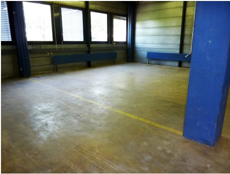
Pavimento in legno-cemento contenente amianto. (Foto: Arcadis AG, Simon Küng)
