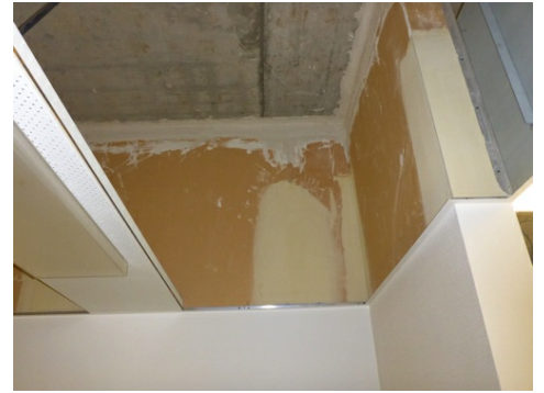
Intonaco contenente amianto. Impiego negli anni '70. (Foto Carbotech AG).
