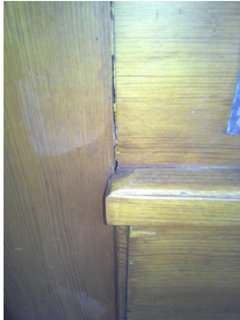
Intonaco contenente amianto su legno. (Foto: Bafob GmbH).
