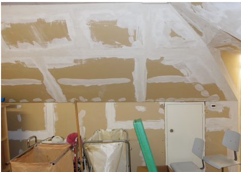
Sigillatura delle lastre in cartongesso prima dell'intonacatura, in questo caso priva di amianto. (Foto Carbotech AG).
