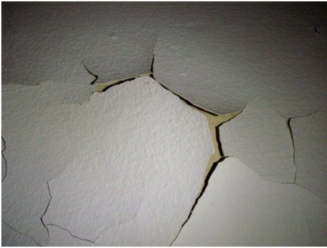
Intonaco che si stacca.
