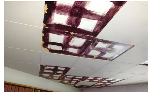
Pannello per controsoffitto con colla contenente amianto, Solgeo
