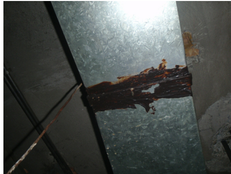
Giunto di un impianto di aerazione sigillato con colla contenente amianto (bitume?).
