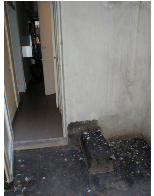
Guarnizione bituminosa con amianto nel cortile interno.
