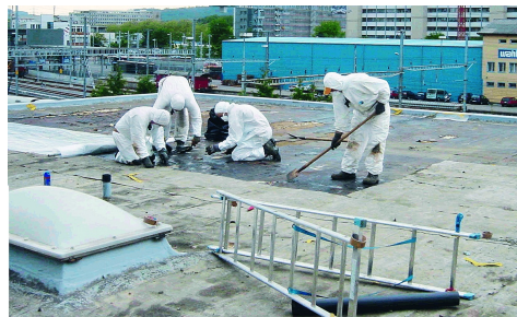
Lastre di bitume contenenti amianto, Suva
