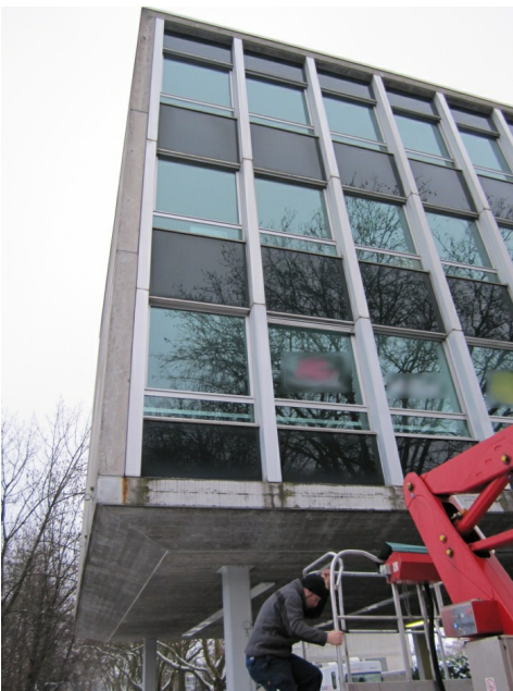
Edificio con amianto floccato nel cassonetto delle tapparelle. (Foto SC+P Sieber Cassina + Partner AG)
