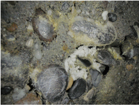
Resti di amianto floccato dopo la bonifica (bianco). Praticamente, il calcestruzzo poroso non può più essere bonificato al 100%.
