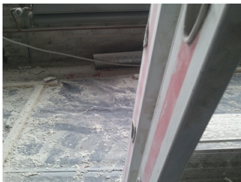
Bonifica da amianto floccato: materiale depositatosi a terra durante i lavori. Tali contaminazioni non sono consentite.
