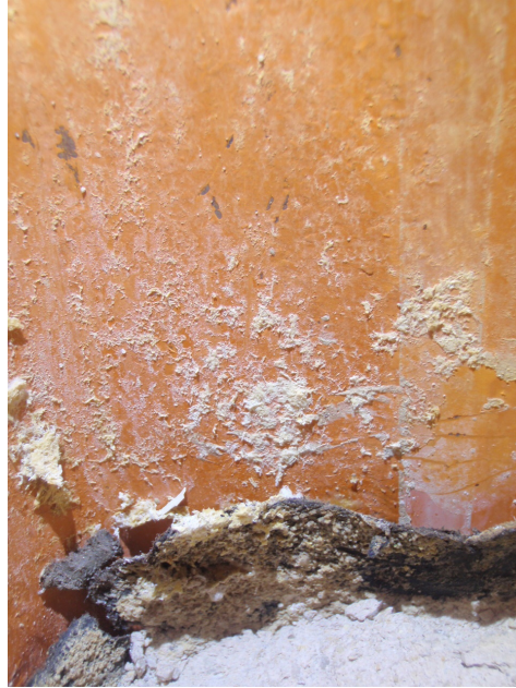
Trave in acciaio non pulita sufficientemente.
