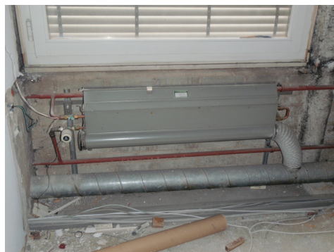
Amianto floccato utilizzato come isolamento termico su un supporto in acciaio (a destra del riscaldamento/della ventilazione).
