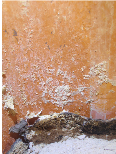
Trave in acciaio non pulita sufficientemente.
