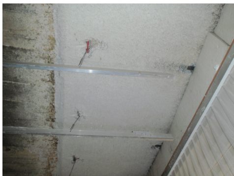
Amianto floccato utilizzato come isolamento termico su una soletta in calcestruzzo.
