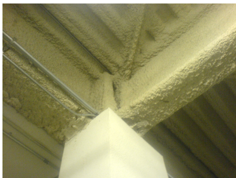
Isolamento floccato utilizzato come protezione antincendio - in questo caso senza amianto (più recente).
