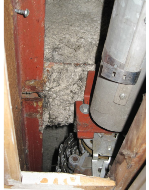
Amianto floccato nel cassonetto delle tapparelle. (Foto SC+P Sieber Cassina + Partner AG)
