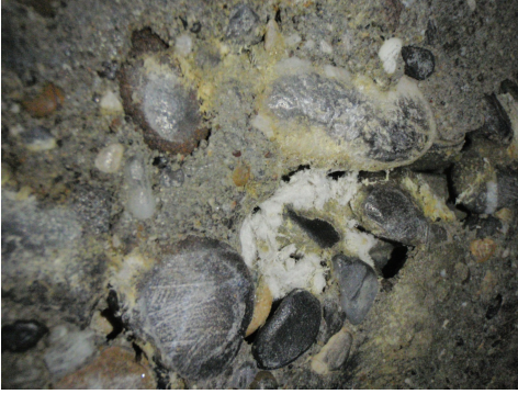
Resti di amianto floccato dopo la bonifica (bianco). Praticamente, il calcestruzzo poroso non può più essere bonificato al 100%.
