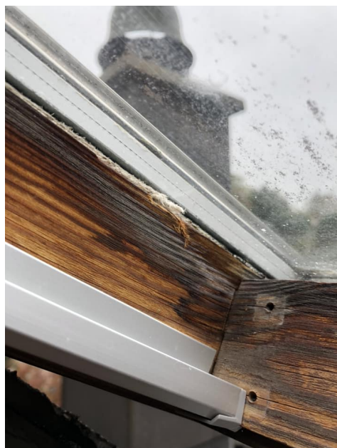
Corda di amianto tra il vetro e il telaio di un lucernario. (Foto Solgeo, J. Meyer)
