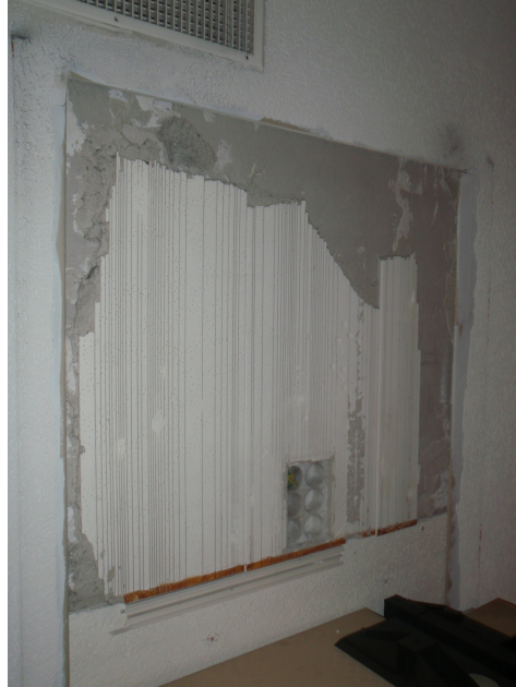
Isolamento acustico posato a parete, già parzialmente rimosso. Normalmente il materiale è di colore grigio all'interno.
