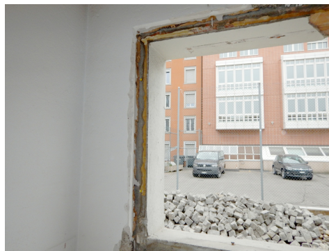
A volte il mastice per battute è inserito in profondità tra l'infisso e la muratura. Lo si può raggiungere dall'esterno rimuovendo localmente l'intonaco della facciata. (Foto A. Pfister, Jäckli AG)
