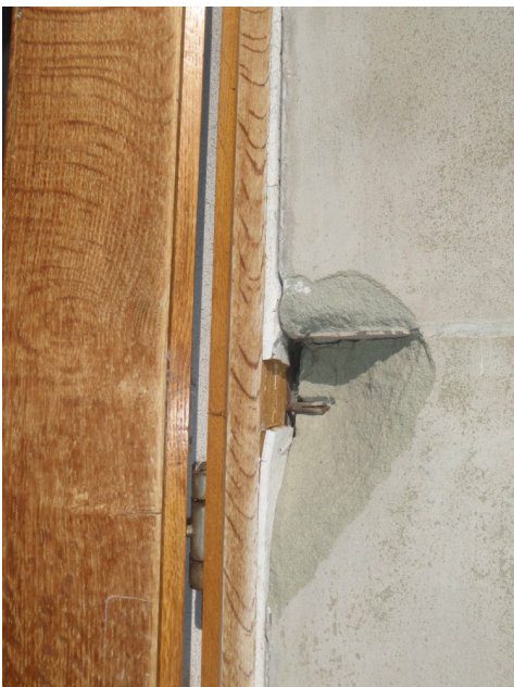
Mastice per battute contenente amianto (tra il telaio della finestra e la muratura).
