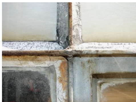
Mastice di finestre in un telaio metallico, Suva
