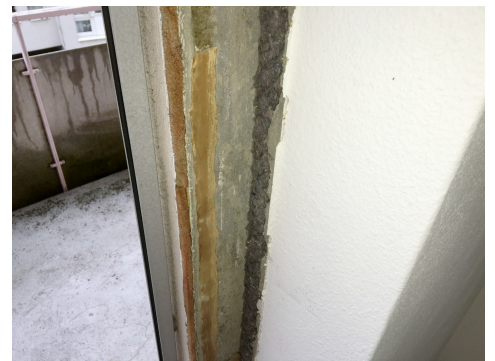
A volte il mastice per battute è inserito in profondità tra l'infisso e la muratura. Lo si può raggiungere dall'esterno rimuovendo localmente l'intonaco della facciata. (Foto A. Pfister, Jäckli AG)
