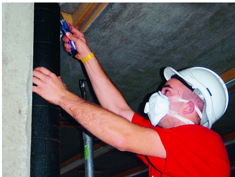
Retrait de l'isolation des conduites avec une peinture bitumineuse contenant de l'amiante, Suva
