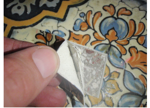
Revêtement de sol multicouches. La couche inférieure a la même consistance que du carton et se détache parfois spontanément. Photo: S. Schneebeili
