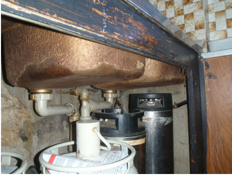
Revêtement d'insonorisation amianté sous évier
