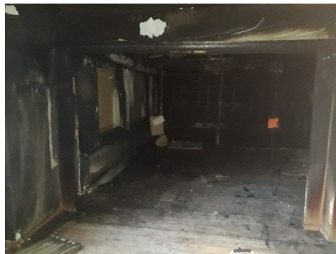
Incendie dans un salon, Markus Durrer, IBH Expertenstelle Chur
