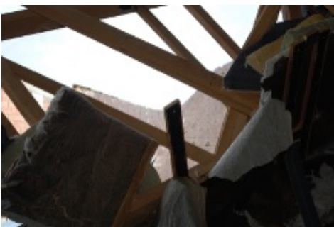
Toit d'une piscine couverte (en fibrociment) effondré sous le poids de la
