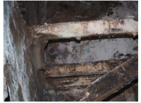
Plafond effondré sous l'effet de la pourriture et de champignons, Markus Durrer, IBH Expertenstelle Chur
