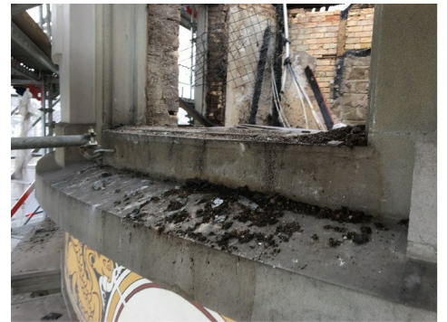
Résidus de bardage en fibrociment sur une façade, Markus Durrer, IBH Expertenstelle Chur
