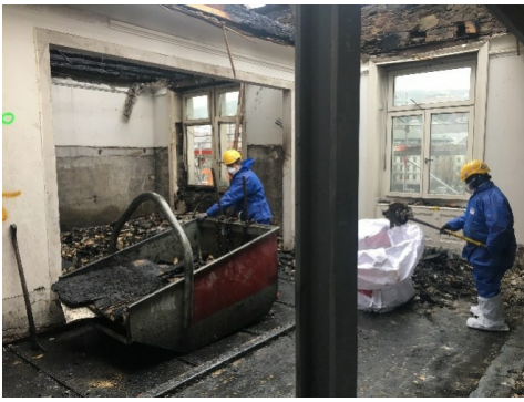
Travaux de déblaiement des fractions grossières et fines, Markus Durrer, IBH Expertenstelle Chur
