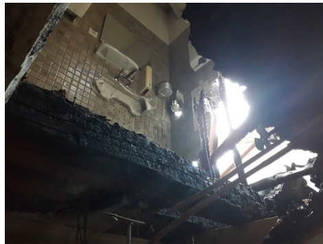
Colle de faïence « impossible à échantillonner et à assainir », Markus Durrer, IBH Expertenstelle Chur
