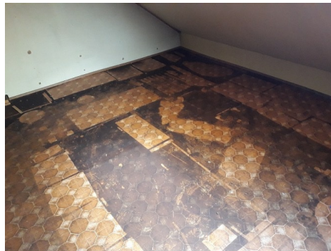
Revêtement de sol encrassé par la suie après travaux de déblaiement, Markus Durrer, IBH Expertenstelle Chur
