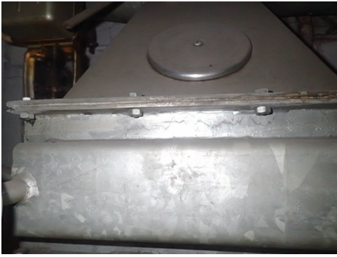
Etanchéité bitumineuse dans gaine de ventilation. Photo: C. Campoarmor, Arcadis Schweiz AG
