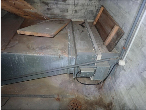
Panneau léger entre les conduits de ventilation, sans source
