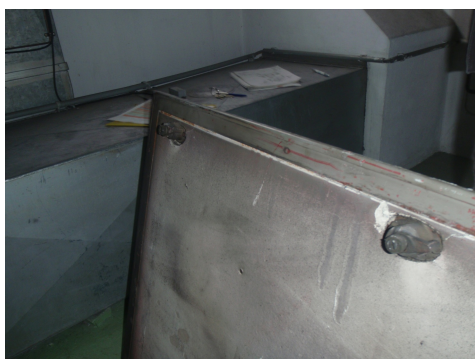
Monobloc de la marque "Svenska" avec amiante dans le plâtre.
