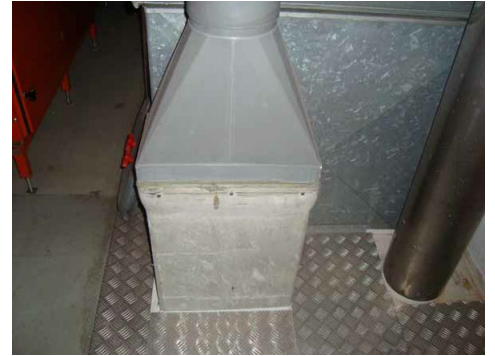
Conduit de ventilation en amiantement, se raccordant au conduit en plastique, Carbotech
