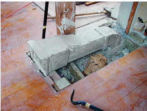
Conduit de ventilation en amiantement
