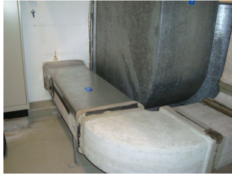
Conduit de ventilation en amiantement, Carbotech
