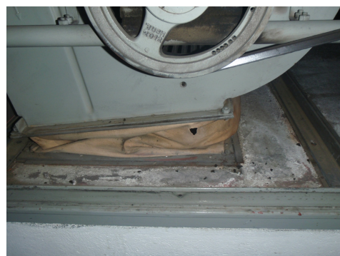
Tissu amianté entre moteur de ventilation et le socle.
