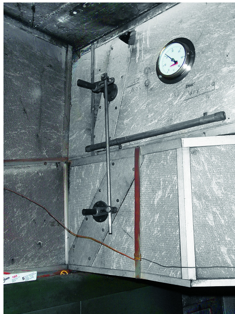
Conduit de ventilation en amiantement
