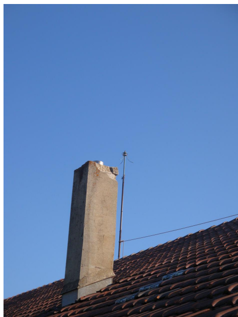
Paratonnerres radioactifs. Photo: G. Di Tommaso et al., BAG
