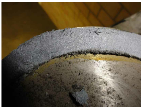
Detail: Litaflex comme protection anti-feu autour d'un tube de chauffage. Photo: Carbotech AG
