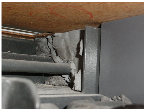
Litaflex comme protection anti-feu autour d'un tube de chauffage. Photo: Carbotech AG
