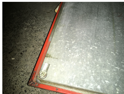
Mousse amiante dans le couvercle d'un monobloc. Photo: M. Hottarek, GEOTEST AG, 2020
