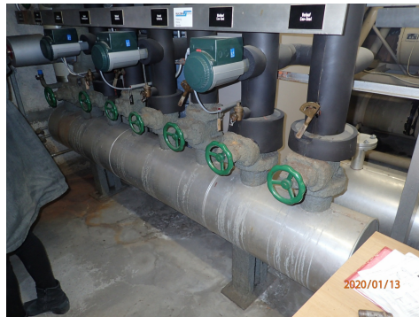
Transpirex avec amiante (20-50 % Chrysotile) dans chaufferie d'une école (Photo: Carlos Campoamor, Arcadis Schweiz AG)
