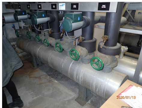
Transpirex avec amiante (20-50 % Chrysotile) dans chaufferie d'une école (Photo: Carlos Campoamor, Arcadis Schweiz AG)
