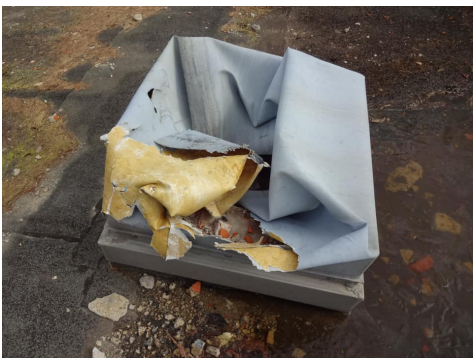
Beschädigte Kaminabdeckung aus Hypalon. Das Dach selber war ebenfalls mit Hypalon abgedeckt (unter der Bitumen-Pappe, die neueren Datums ist). Photo: J. Meyer, Solgeo AG
