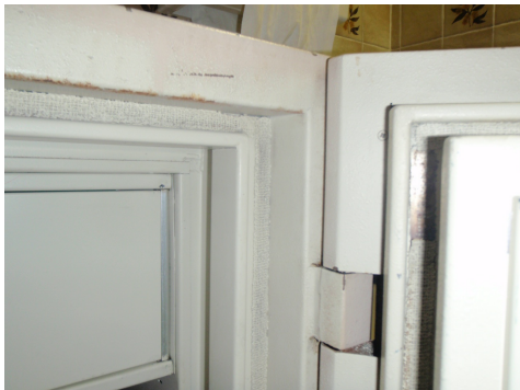
Coffre-fort avec étanchéité en tissu amianté. Photo, Picadus, S. Schneebeli
