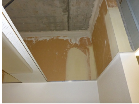
Enduit contenant de l'amiante. Pose dans les années 1970. Photo de Carbotech AG
