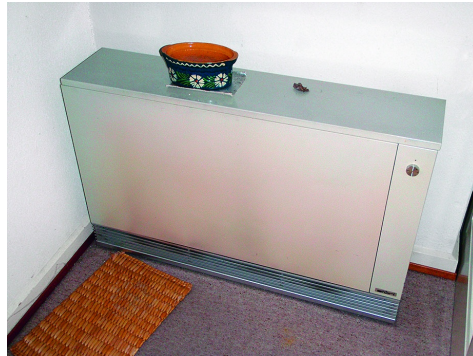
Chauffages électriques à accumulation
