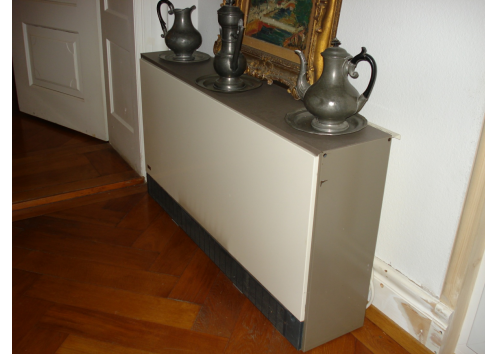
Chauffage électrique à accumulation, Carbotech
