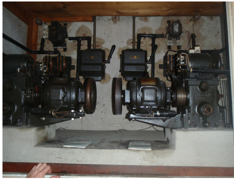
Photo moteur monte / monte charge dans restaurant. Les plaquettes de frein sont potentiellement amiantés.
