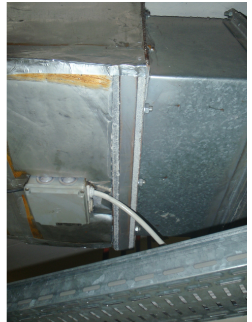
Panneaux légers contenant de l'amiante entre des canaux de ventilation
