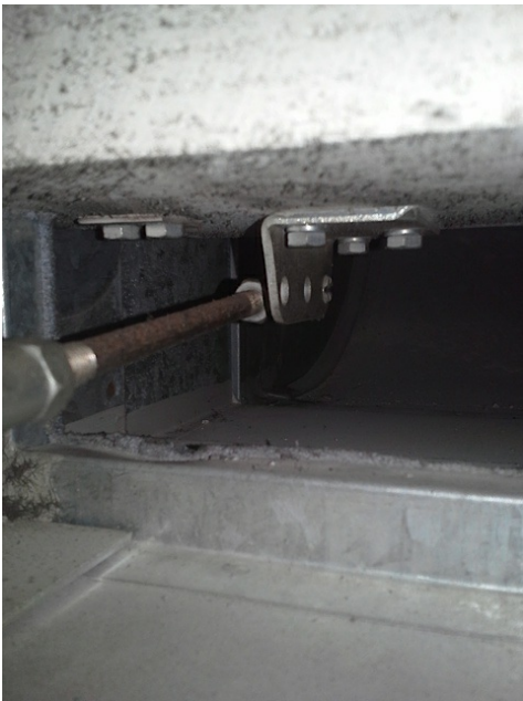
Clapet coupe-feu avec joint d'étanchéité amianté
