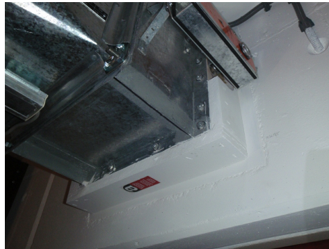
Panneaux léger amianté autour de gaine de ventilation
