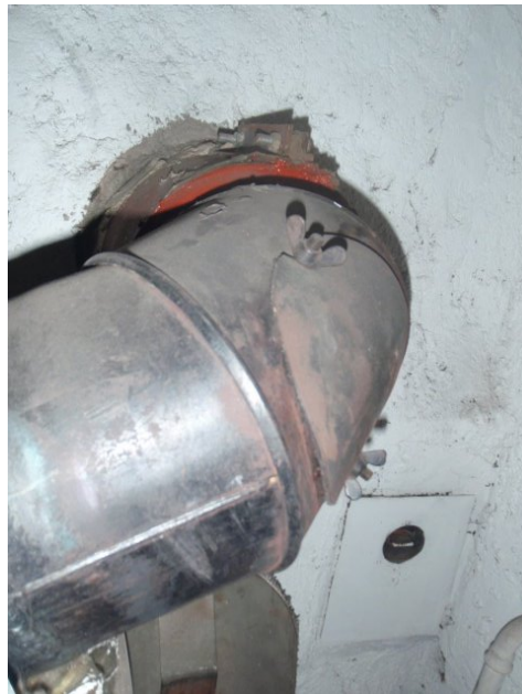
Dans les conduits de cheminées, on trouve parfois aussi des joints d'étanchéité en tissu amianté.
