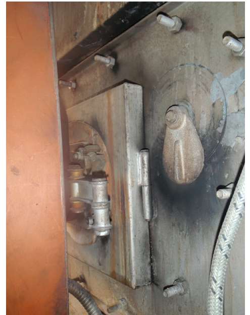
Les joints d'étanchéité des brûleurs à mazout peuvent être en mauvais état et, par conséquent, représenter un certain danger pour la santé des utilisateurs.
