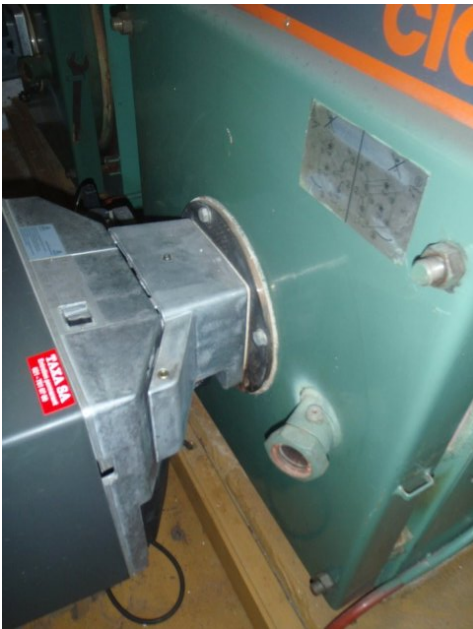
Joint d'étanchéité d'un brûleur à mazout d'une installation de chauffage. Il s'agit ici d'un matériau faiblement aggloméré.
