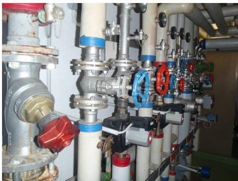
D'anciens joints plats d'étanchéité contiennent très souvent de l'amiante.
