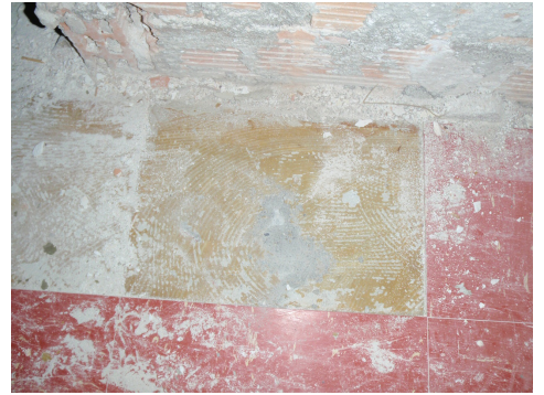
Colle non bitumineuse sous dallette vinyle. Celle-ci peut également contenir de l'amiante.
