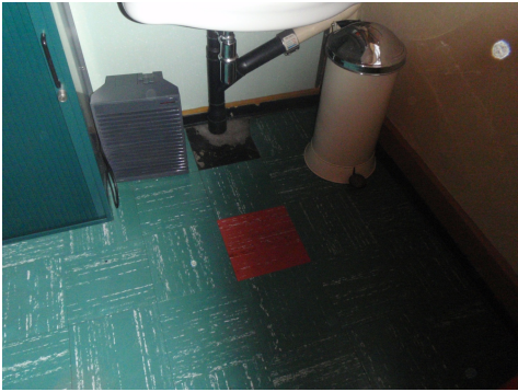
Dallete Vinyle contenant de l'amiante
