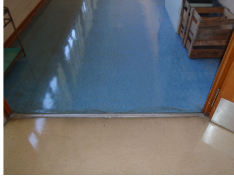
Des revêtements de sol du type linoléum sont susceptibles de contenir de l'amiante.
