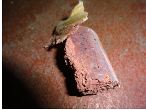
Revêtement de sol en bois-ciment amianté
