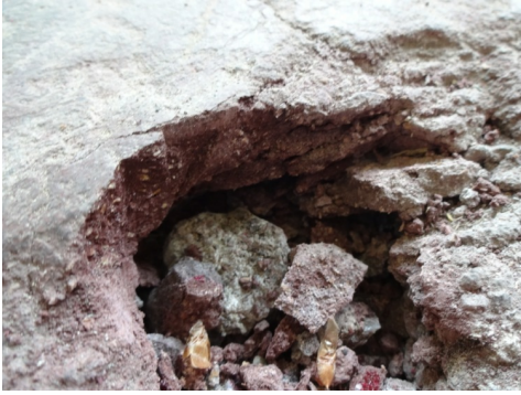
Revêtement de sol en bois-ciment amianté
