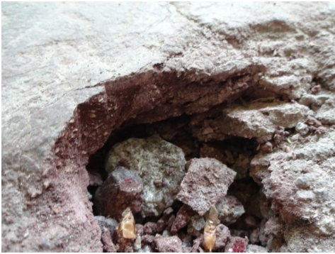
Revêtement de sol en bois-ciment amianté
