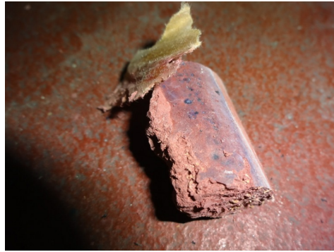
Revêtement de sol en bois-ciment amianté
