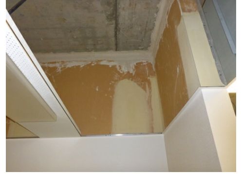
Photo d'enduit avec amiante
