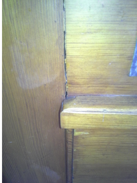
Enduit contenant de l'amiante sur du bois. Photo: Bafob GmbH
