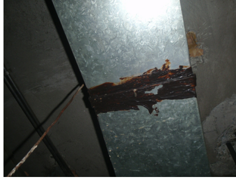
Joint de ventilation avec de la colle amiantée (bitumineuse ?)
