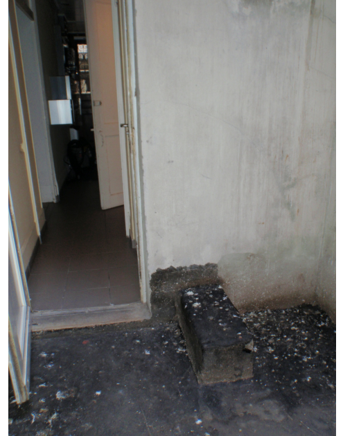
Etanchéité bitumineuse contenant de l'amiante dans une cour intérieure
