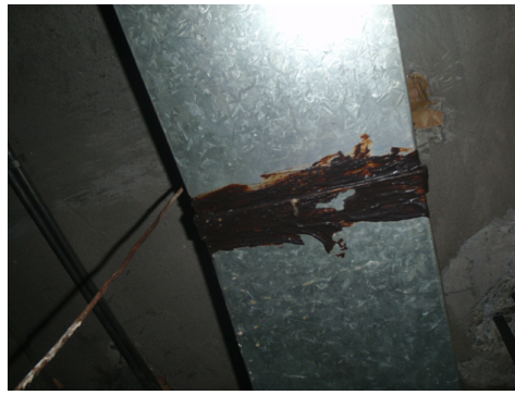
Joint de ventilation avec de la colle amiantée (bitumineuse ?)
