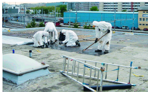
Lé de bitume contenant de l'amiante, Suva
