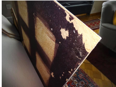
Plaques de faux plafonds avec colle amiantée, Solgeo
