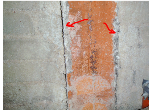
Poutres en acier nettoyées de manière insuffisante. De tels éléments doivent être assainis une nouvelle fois.
