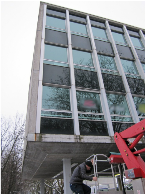
Bâtiment contenant de l'amiante dans les caissons de stores. Photo SC+P Sieber Cassina + Partner AG
