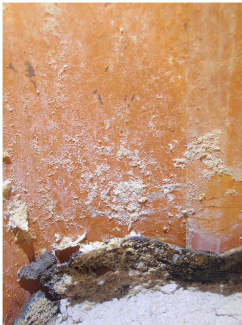
Poutres en acier nettoyées de manière insuffisante.
