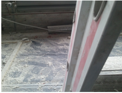
Amiante floqué réparti sur le sol pendant l'assainissement. De telles contaminations ne sont pas autorisées pendant l'assainissement. De plus, le matériau doit être humidifié pendant l'assainissement.
