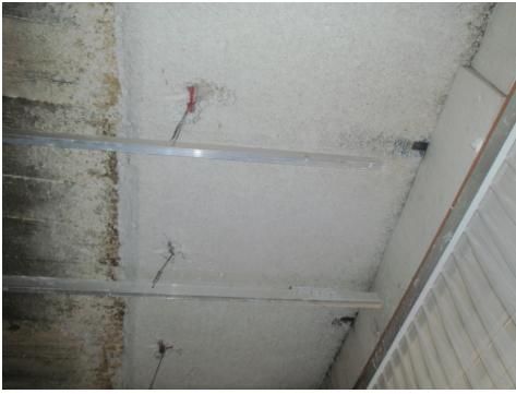
Amiante floqué utilisé comme isolation thermique sur une dalle en béton.
