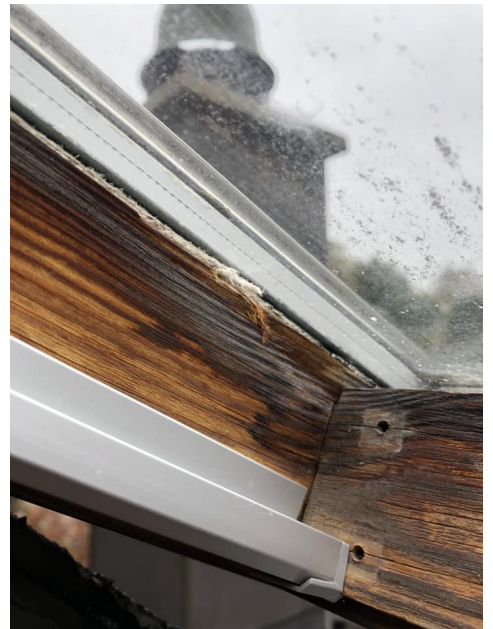
Fil amianté sur fenêtre en toiture. Photo Solgeo, J. Meyer
