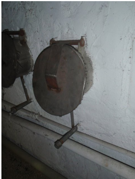
Clapets de cheminée avec tissu amianté
