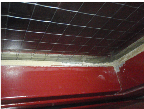
Portes coupe-feu avec du tissu amianté sous du mastic de fenêtre
