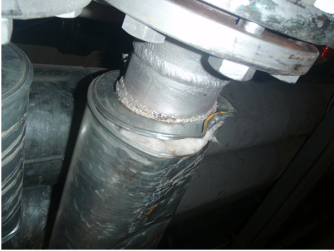
Tissus amiantés sur tuyau.
