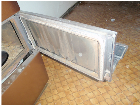
Bande amiantée dans un poêle à mazout
