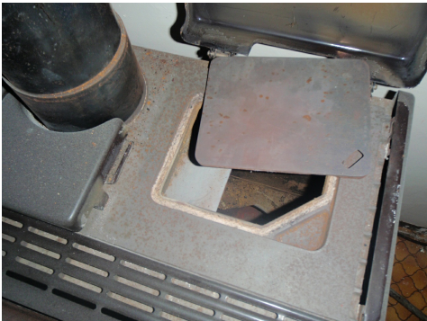
Bande amiantée dans un poêle à mazout
