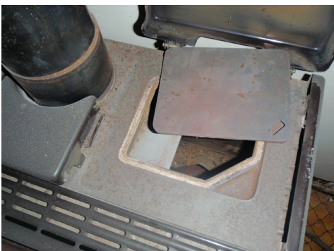
Bande amiantée dans un poêle à mazout
