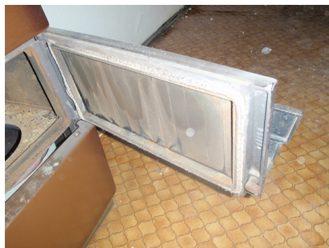
Bande amiantée dans un poêle à mazout
