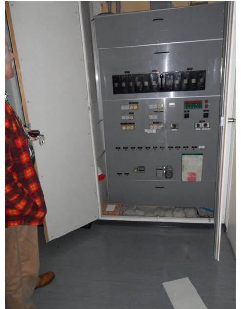
Photo de coussin d'amiante et de panneau léger contenant de l'amiante dans une armoire électrique
