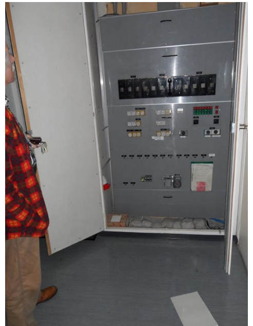
Photo de coussin d'amiante et de panneau léger contenant de l'amiante dans une armoire électrique
