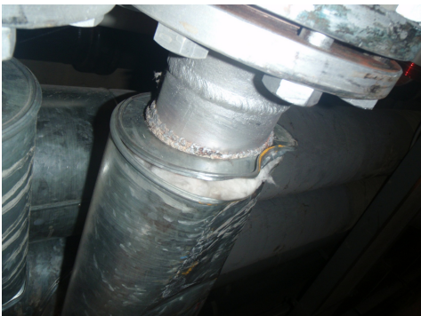
Tissus amiantés sur tuyau.
