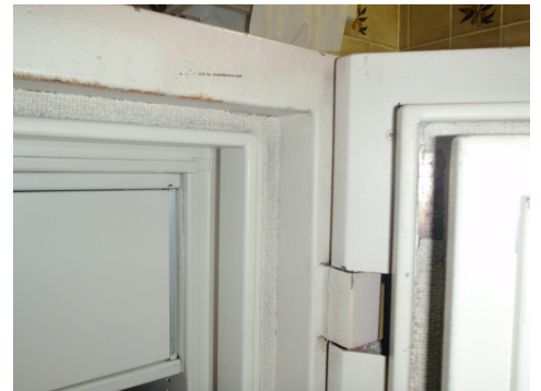
Tissus amiantés dans un coffre-fort
