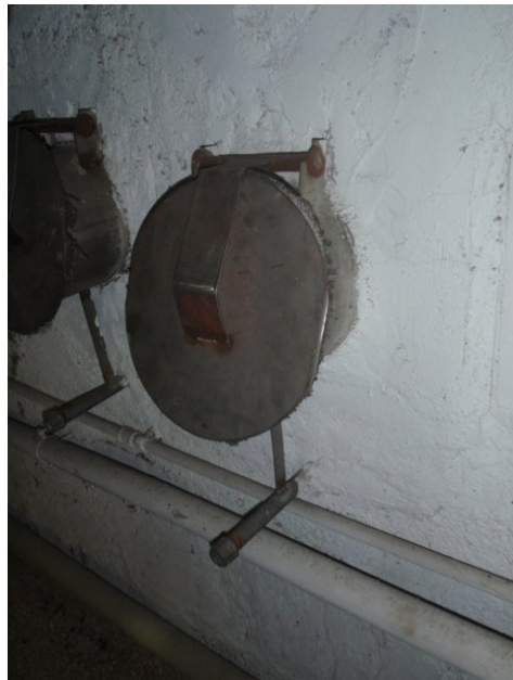
Clapets de cheminée avec tissu amianté
