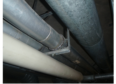
Bande/tissu amiantée sous une bride de tuyau
