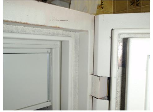
Tissus amiantés dans un coffre-fort
