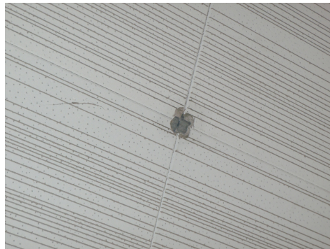
Faux plafond avec plaques acoustiques après échantillonnage.
