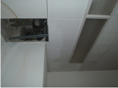
Faux plafonds acoustiques
