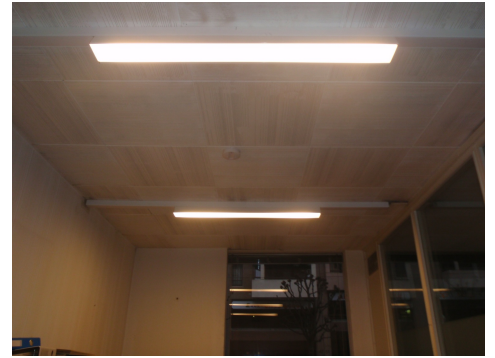
Faux plafonds acoustiques
