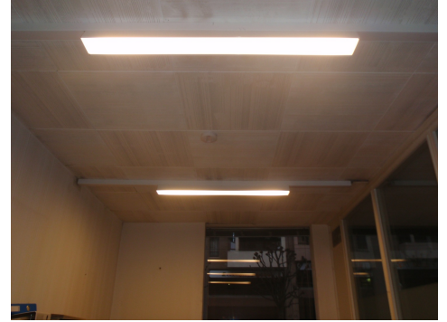
Faux plafonds acoustiques
