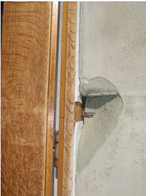
Masse d'égalisation contenant de l'amiante (entre le cadre de porte et la maçonnerie).
