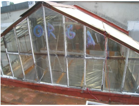
Toiture en verre avec mastic de fenêtre amianté. Photo Picadus, S. Schneebeli
