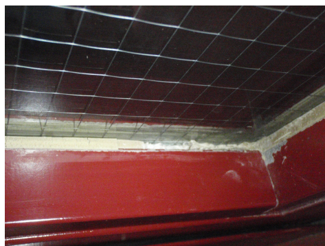
Porte coupe-feu avec un fil amianté
