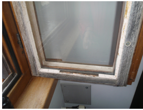
Mastic de fenêtre amianté. Même lorsque ce mastic se décolle, il ne représente aucun danger pour la santé des personnes à proximité.
