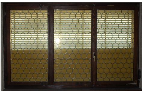
Vitreaux avec mastic amianté. Si les verres synthétiques étaient directement en contact avec le mastic, celui-ci ne
