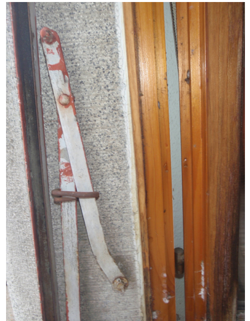
Masse d'égalisation contenant de l'amiante (entre le cadre de fenêtre et la maçonnerie)
