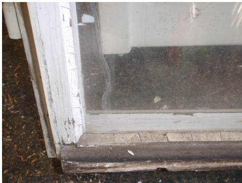
Mastic de fenêtres d'un cadre en bois avec double vitrage, Suva
