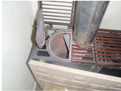
Asbest-Schnur bei Öffnung von Öl-Ofen
