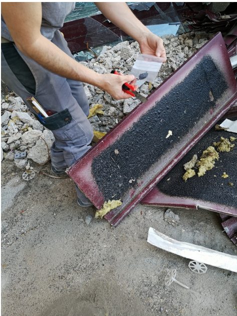
Fassaden-Platten mit asbesthaltiger bituminöser Beschichtung. Photo: C. Campoarmor, Arcadis Schweiz AG
