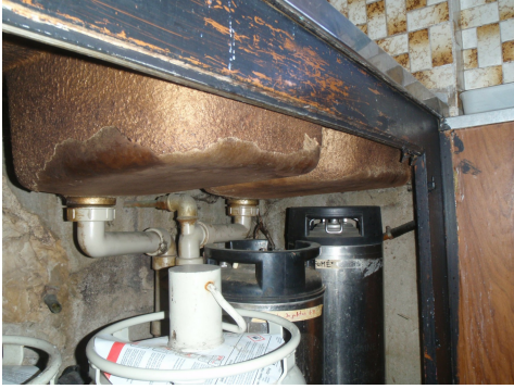
Verputz/Dröhnschutz unter Lavabo mit Asbest
